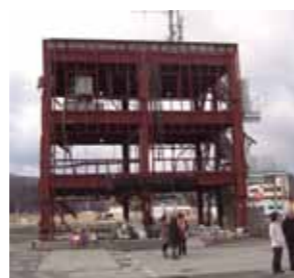
南三陸町の防災対策庁舎。約12mの津波が襲い、41人が犠牲になった。町職員遠藤未希さんの「天使の声」が埼玉県の公立高校の教材に。
